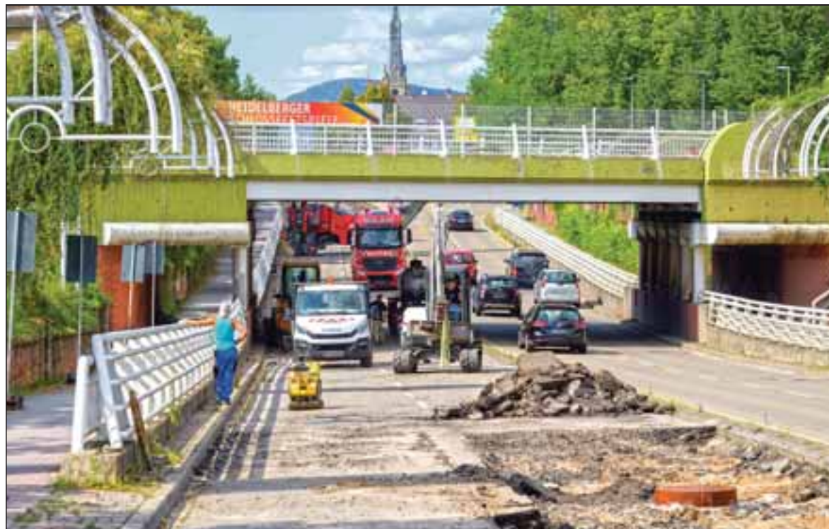
Durch das Unwetter am Samstagabend wurde ein Teil der Römerstraße beschädigt – und zwar in der Senke, über die die Radwegbrücke verläuft. Dort hatten die enormen Mengen an Regenwasser Teile der Fahrbahn nach oben gedrückt. Deswegen sind die beiden Fahrstreifen in Richtung Rohrbach zwischen Lessing- und Feuerbachstraße gesperrt – und so bildeten sich auf der Umleitung, vor allem in Richtung Franz-Knauff-Straße, lange Staus (rechtes Bild).
